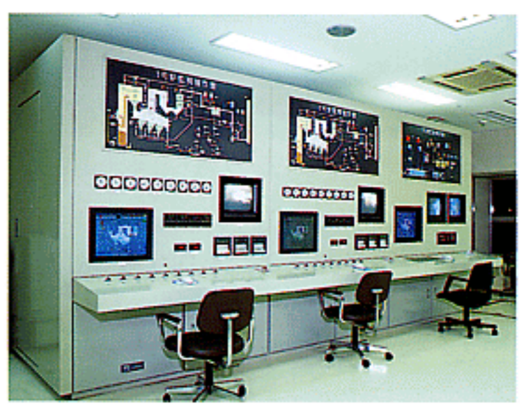
中央制御室 最新の自動制御技術を導入したワンルーム・コントロール方式です。燃焼管理はもちろん、各設備の監視運転操作を行います。
