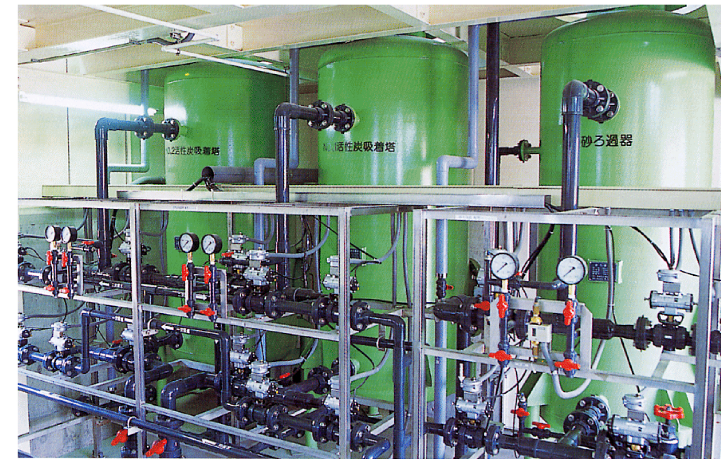
砂ろ過・活性炭吸着塔
