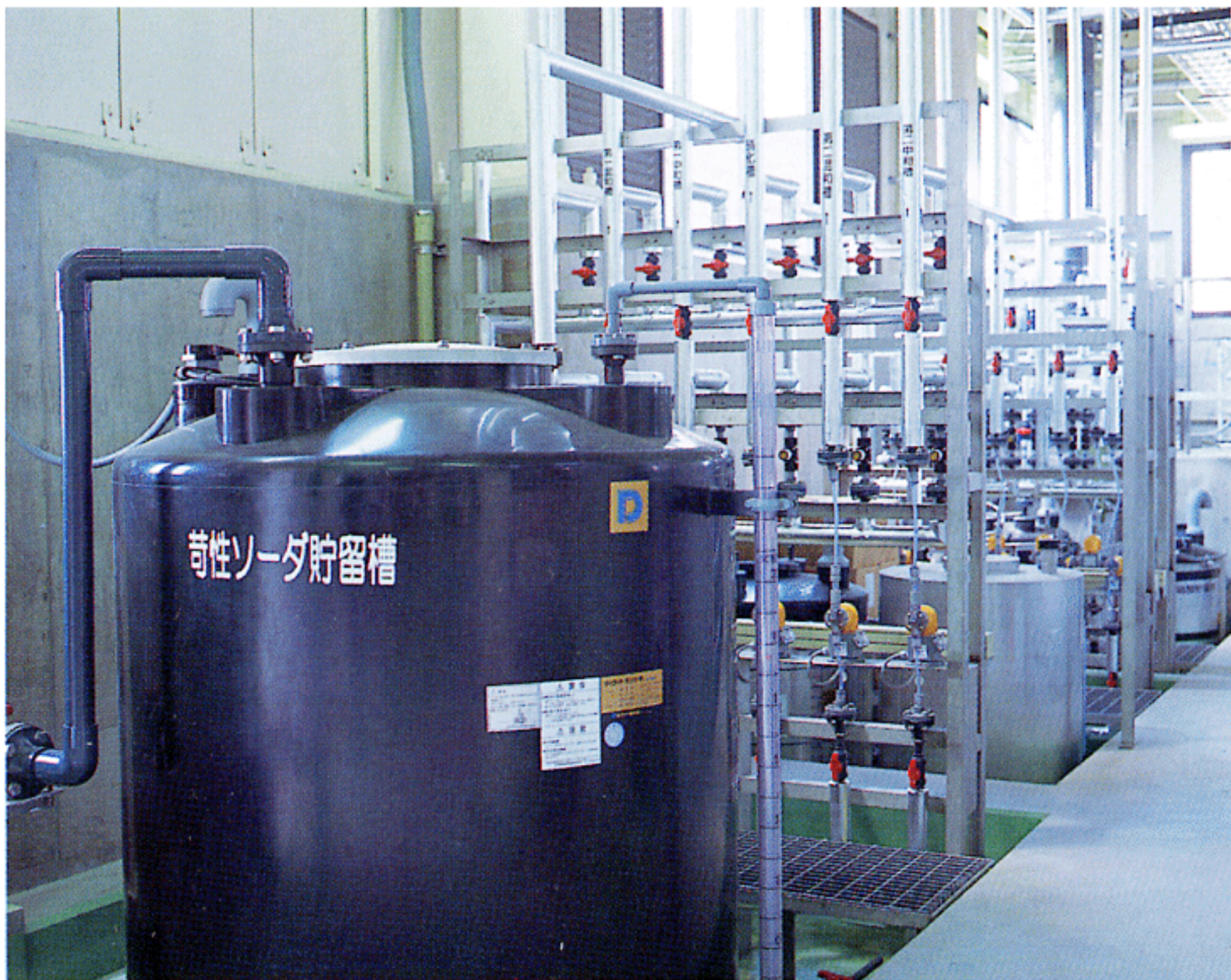
薬品注入設備
