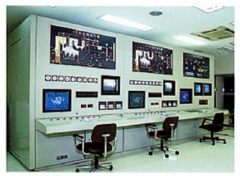
中央制御室 最新の自動制御技術を導入したワンルーム・コントロール方式です。燃焼管理はもちろん、各設備の監視運転操作を行います。
